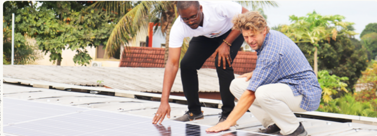
Panneaux solaires nouvellement installés / The newly installed solar panels
